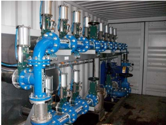
Une partie des conduites de biogaz
