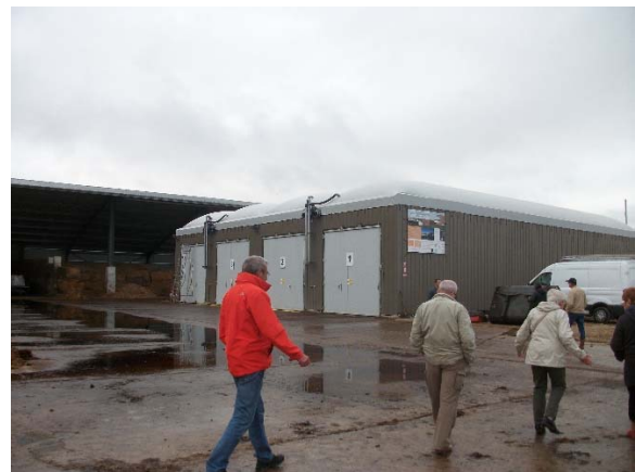
Le cœur de l'installation les 4 digesteurs accolés
