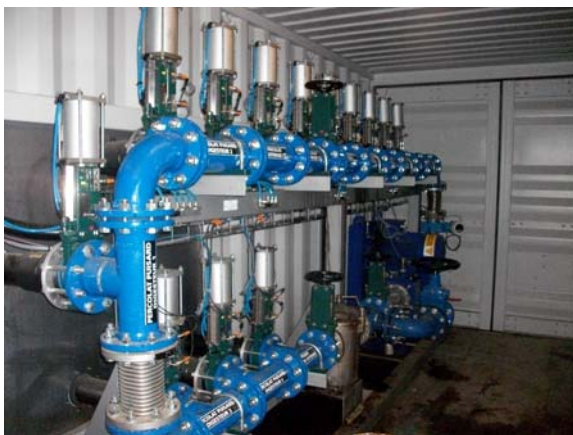
Une partie des conduites de biogaz
